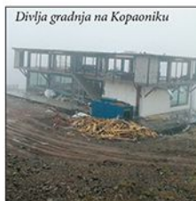
Divlja gradnja na Kopaoniku
